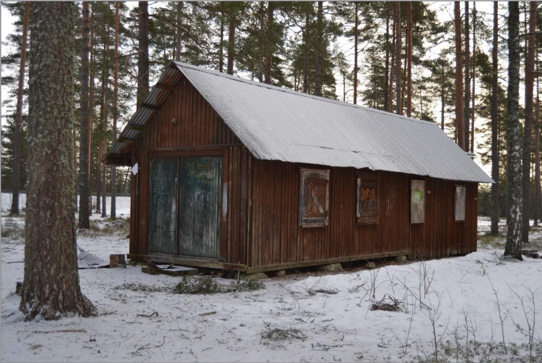
Kuva 21. Rakennuksen läntinen pääty (kuvassa vasemmalla) on rakennettu ensin ja itäinen pääty vuoden 1941 jälkeen. Vasemmanpuoleisin ikkuna toimi aikoinaan kanttiin myyntiluukkuna. (Peltonen 2013, s. 55.)
